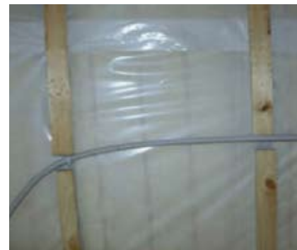
Afbeelding 4: Leidingspouw langs de binnenzijde van het luchtscherm
